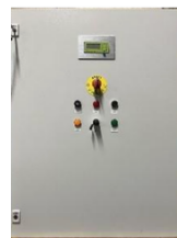
Vor verkabelter Entkopplungskasten
